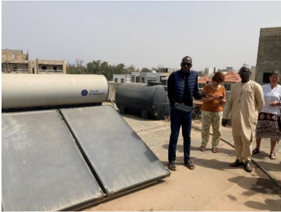
Auf dem Dach von Petit Mbao, neben der solaren Warmwasserbereitung ist noch viel Platz für Solarstromgewinnung
